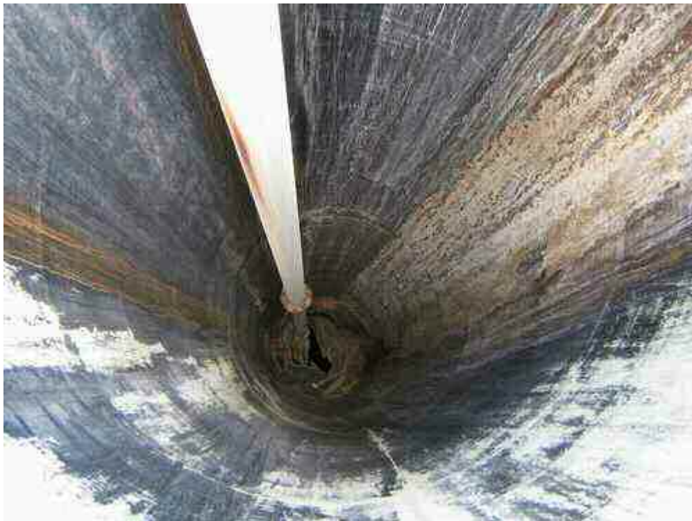
Abbildung 8: Erste Einbruchstelle in zwölf Metern Tiefe
